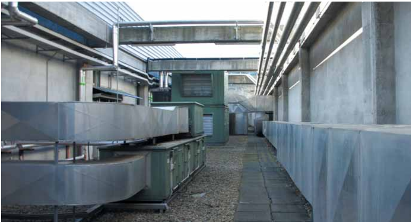
UTAs de uno de los pabellones (fot. J. Terés)
