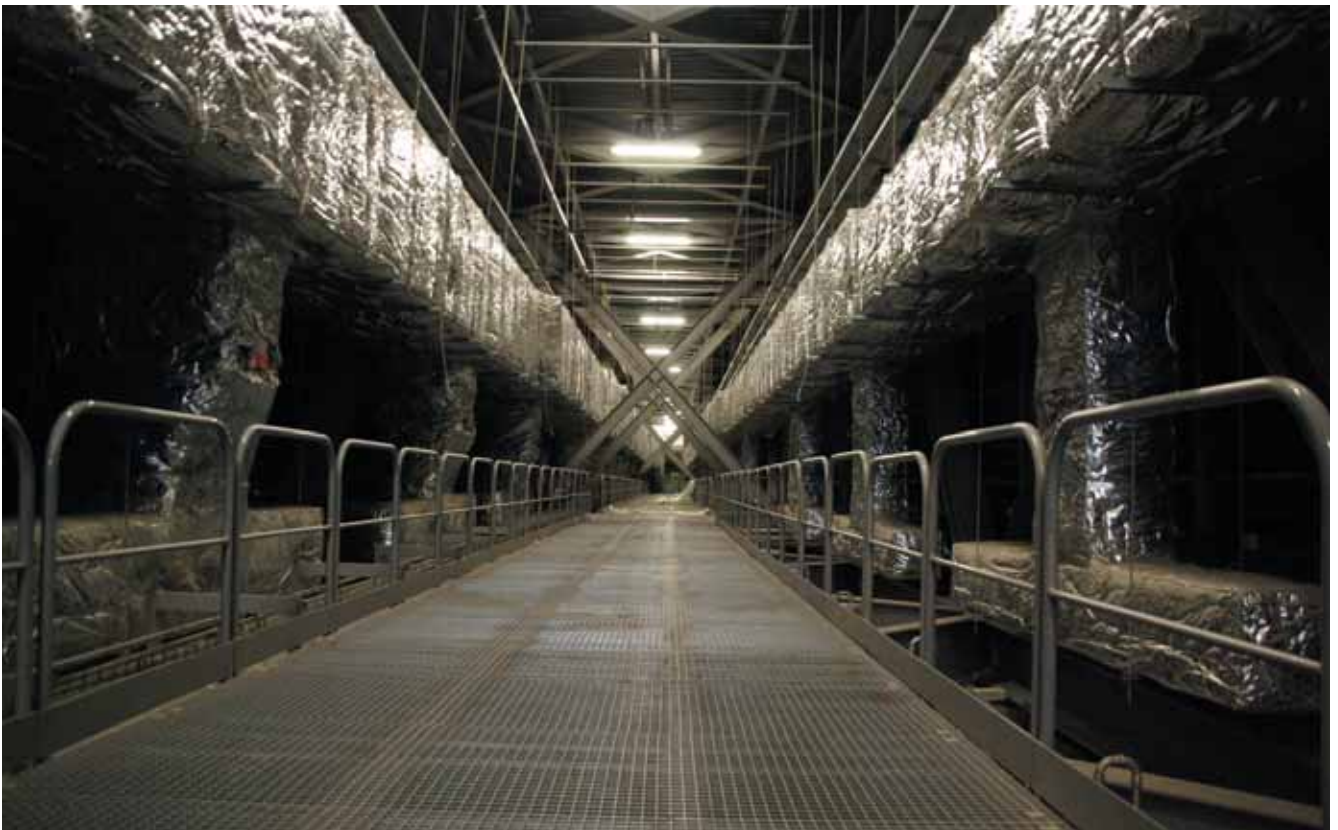
Interior de una jácena con los conductos de climatización. Obsérvense las embocaduras a las toberas de impulsión de aire (fot. J. Terés)
