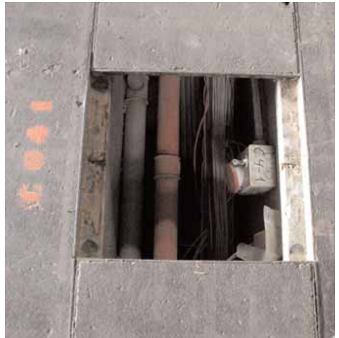
Interior de un canal de servicios donde se aprecia la tubería de incendios, la tubería de fontanería, la red eléctrica y la red de datos (fot. J. Terés)
