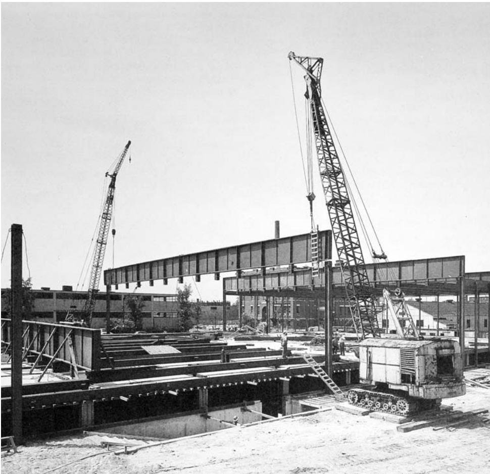
Fig. 15. Crown Hall . ITT de Chicago. Chicago, 1950-1956. Montaje de las vigas de la estructura. Arq. Mies Van der Rohe.
