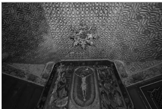
Fig. 19. Cetina (Zaragoza). Castillo de los Liñán. Capilla. Detalle del sistema de cubierta. Foto: Javier Ibáñez Fernández.
