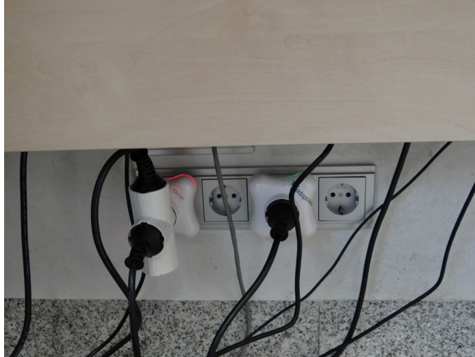
Figura 8. Imagen de los medidores de consumo eléctrico instalados en una sala de reuniones correspondientes a un ordenador (con doble entrada para medir el consumo de CPU y monitor al mismo tiempo) y una impresora.
