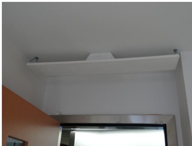
Figura 12. Antena RFID sobre la puerta de acceso de una sala de reuniones.
