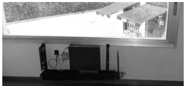
Fig. 5. Instalación de la unidad en el salón de la vivienda. Imagen: Departamento de Máquinas y Motores Térmicos, EHU-UPV
