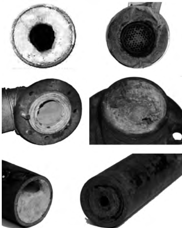
Fig. 11. Obstrucción de conducciones por depósito de incrustaciones
