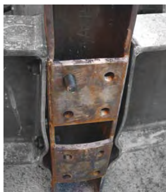
(a) Visión global. Se muestra el pilar invertido, por lo que la zona de tracción es la inferior
