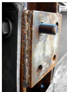
(b) Deformación de la chapa adicional en la zona de compresión
