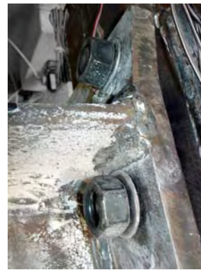
(c) Tornillos zafados en la zona de tracción y deformación de la chapa de testa
