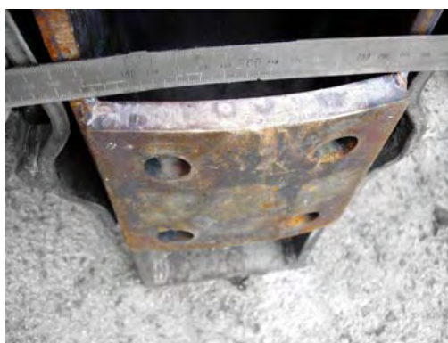
(c) Deformación de la chapa adicional en la zona de tracción
