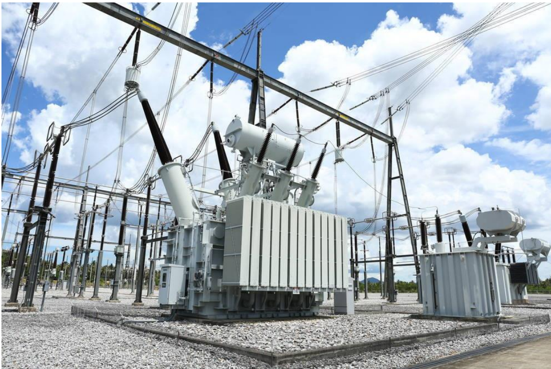
Figura 21 Transformador de potencia de una subestación eléctrica.
