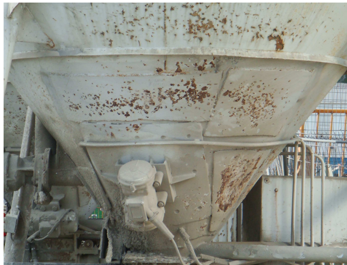
Figura 1.10: Fotografía de un silo de almacenamiento de áridos, en el que se observan las marcas de golpes en su pared, para reanudar el flujo de material. En primer plano se puede ver un vibrador de motor con masa excéntrica utilizado para mejorar el flujo.
